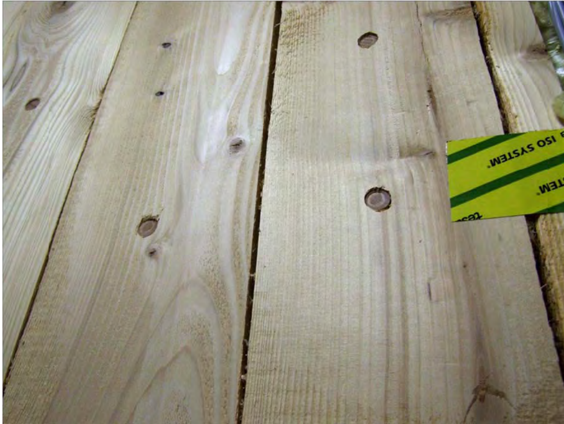
Abb. A-4: Stand der Innenoberfläche (Massivholz-Lage) bei der Massivholzkonstruktion nach einem Jahr; Spalten zwischen den Brettern (oben), Detail mit Verdübelung eines Brettes (unten)
